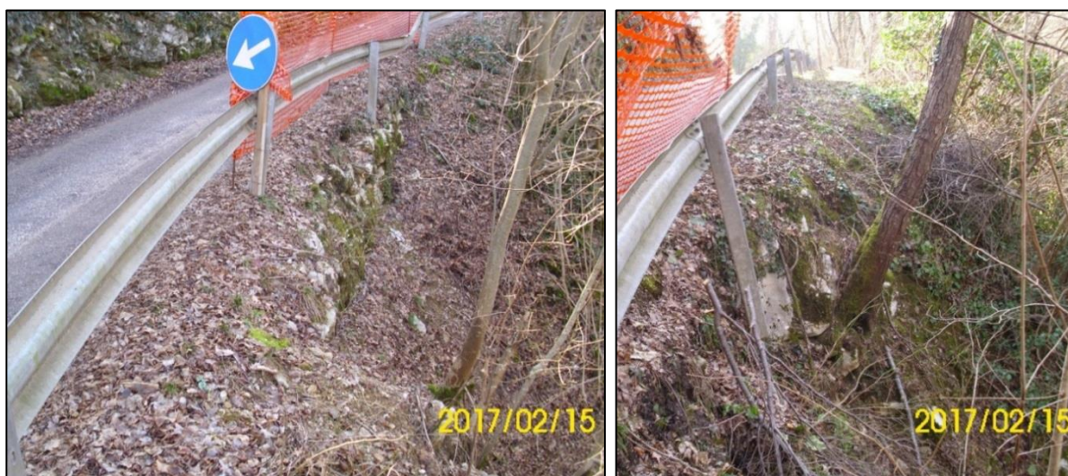
Figura 8 - Documentazione fotografica della scarpata di valle in dissesto
