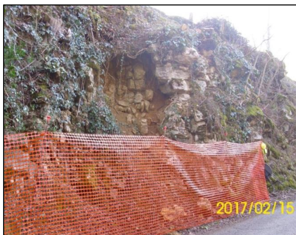
Figura 9 – Scarpata di monte in dissesto
