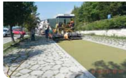
6) Parcheggio del centro sportivo di Pradipaldo - Ultimato l'intervento sul parcheggio del centro sportivo con materiale drenante.
