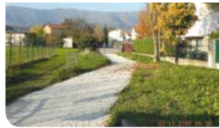
5) Nuovo accesso carraio per il bocciodromo - È in corso di realizzazione il nuovo accesso al bocciodromo comunale che permetterà di mettere finalmente in sicurezza l'area del centro sportivo.
